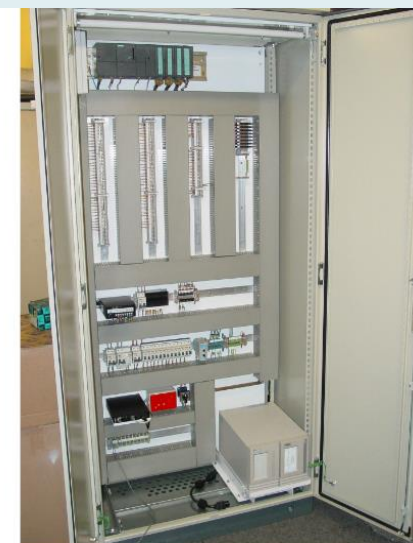
UPS داخلی پنل PLC
