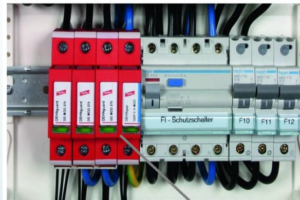
Surge Protector در مسیر خطوط تغذیه
