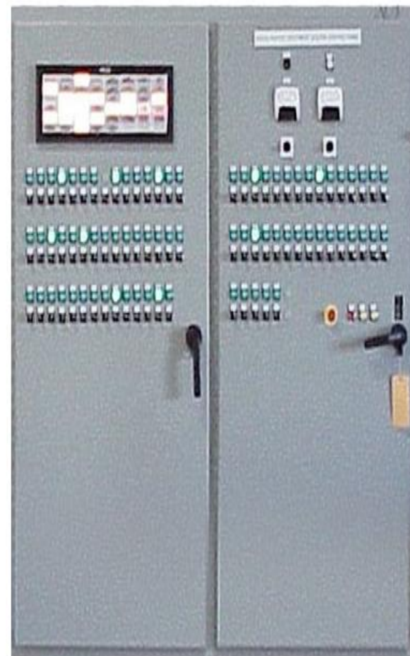
نمونه تجهیزات روی درب پنل
